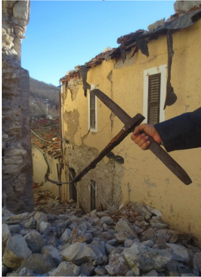
Système d'ancrage métallique pour poutre de connexion en bois détaché de la poutre détériorée
