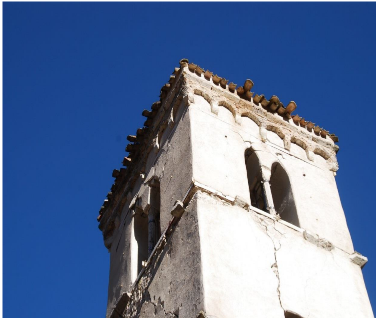
Clocher de S. Martino de Gualdesi en Castelsantangelo sul Nera (MC) avec frettage avec des lames métalliques en acier inoxydable.
