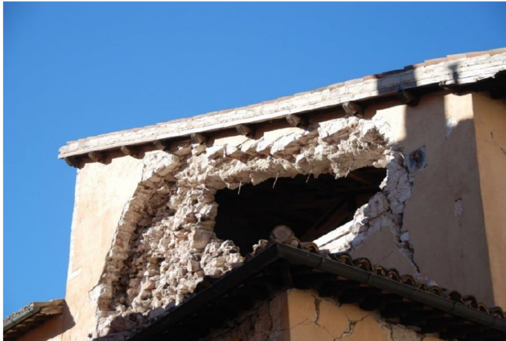
Effondrement partiel de la maçonnerie en dessous de bordure en béton, avec des ancrages verticaux restant libre. Visso (MC).
