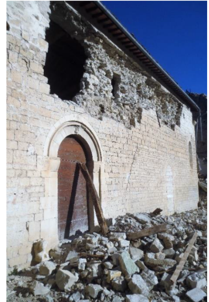
Eglise de S. Stefano à Castelsantangelo sul Nera (MC), effondrement de la face extérieure dans la zone située sous le bord en béton armé
